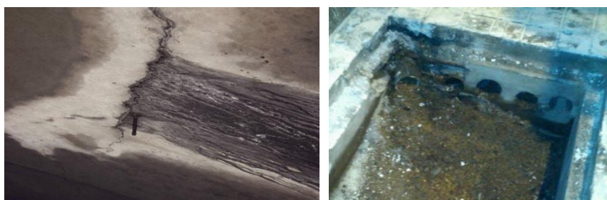
Fig. 6. Aduela 28 da galeria Norte. Escorrências e depósitos ao longo de fissura situada no tecto da abóboda. Caixa de inspeção colmatada, nos drenos de descarga [7].
